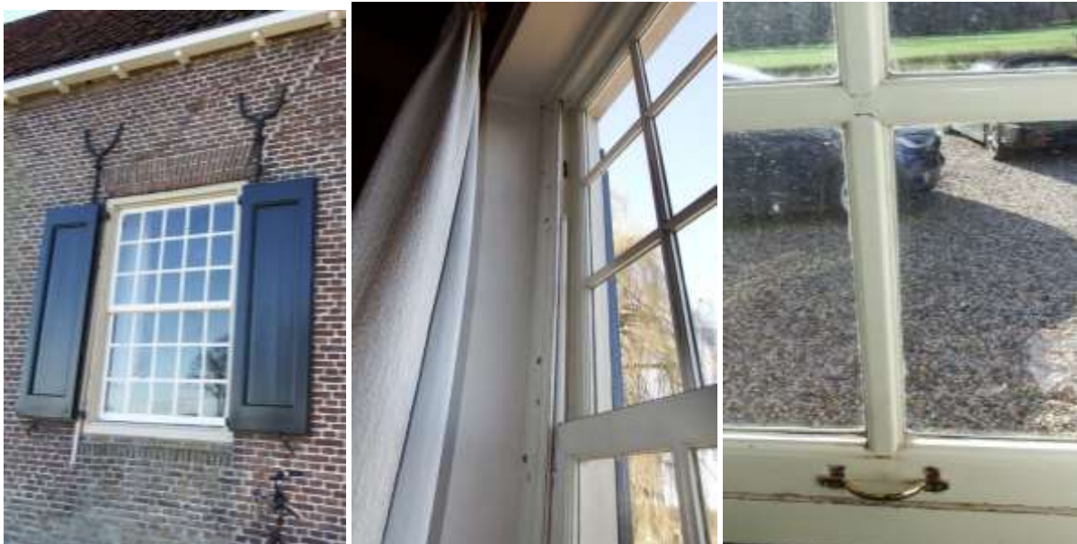
Afb. 22: Het rechter venster in de voorgevel(links), de binnenzijde van het venster met de katrol en het vervangende veersysteem (midden) en een overkruising van afgeronde rechthoekige roedeprofielen (rechts).
