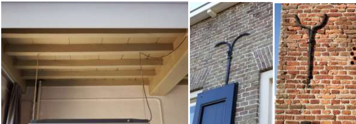
Afb. 15: Samengestelde balklaag in de opkamer (links) en de ankervormen op het metselwerk (midden en rechts).
