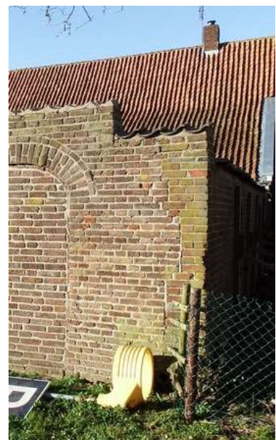
Afb. 5: Blokvertanding bij de aansluiting van de zijgevel op de achtergevel.
