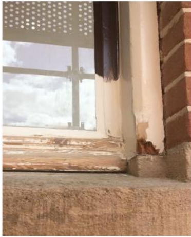
Afbeelding 1: Voorbeeld van het vernieuwen van het schilderwerk, waarbij de oude verf lagen op de onderdorpel van het raamhout vrijwel geheel verwijderd zijn om een goede hechting te verkrijgen. Het ondereind van de kozijnstijl is nog niet hersteld, bij deze omvang te herstellen met behulp van een vulmiddel.
