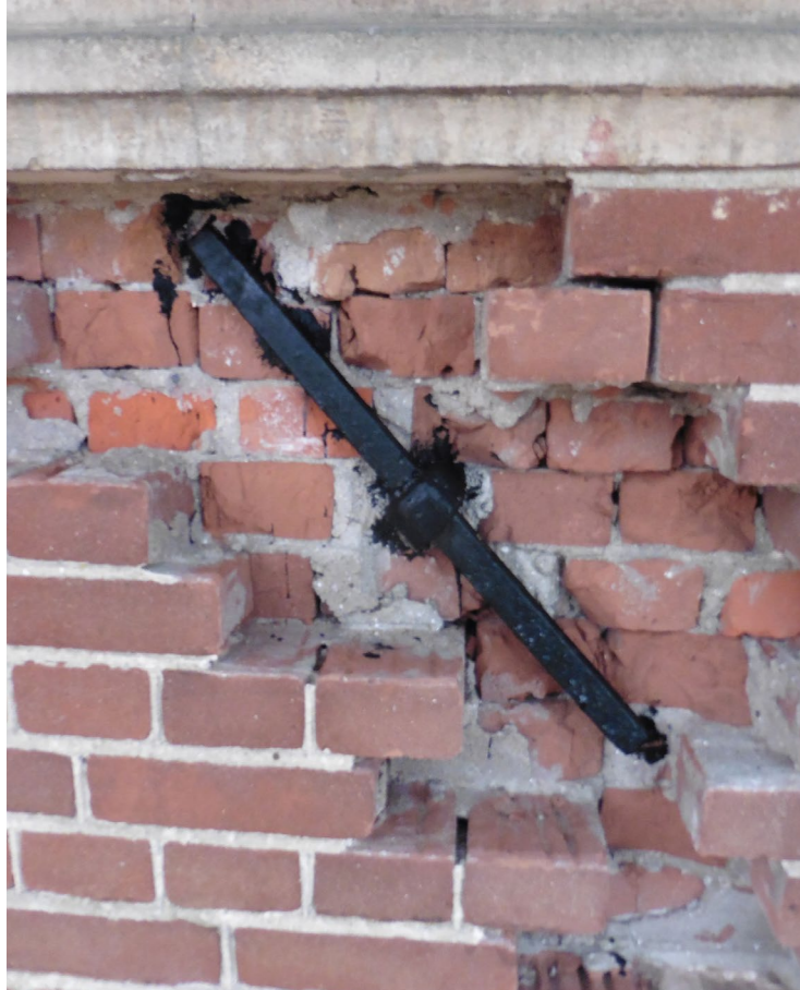
Afbeelding 1: Voorbeeld van uitgetand beschadigd metselwerk, in dit geval ten gevolge van een corroderend schootanker wat zich in het metselwerk bevindt.
