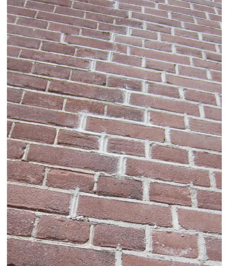
Afbeelding 4: Een ander voorbeeld van een metselwerk vlak met rechts vernieuwd voegwerk en links het oorspronkelijke voegwerk. Het verschil in de stootvoegdikte valt hierbij ook op, hier ook veroorzaakt door het maatverschil van de nieuwe ingeboete bakstenen.
