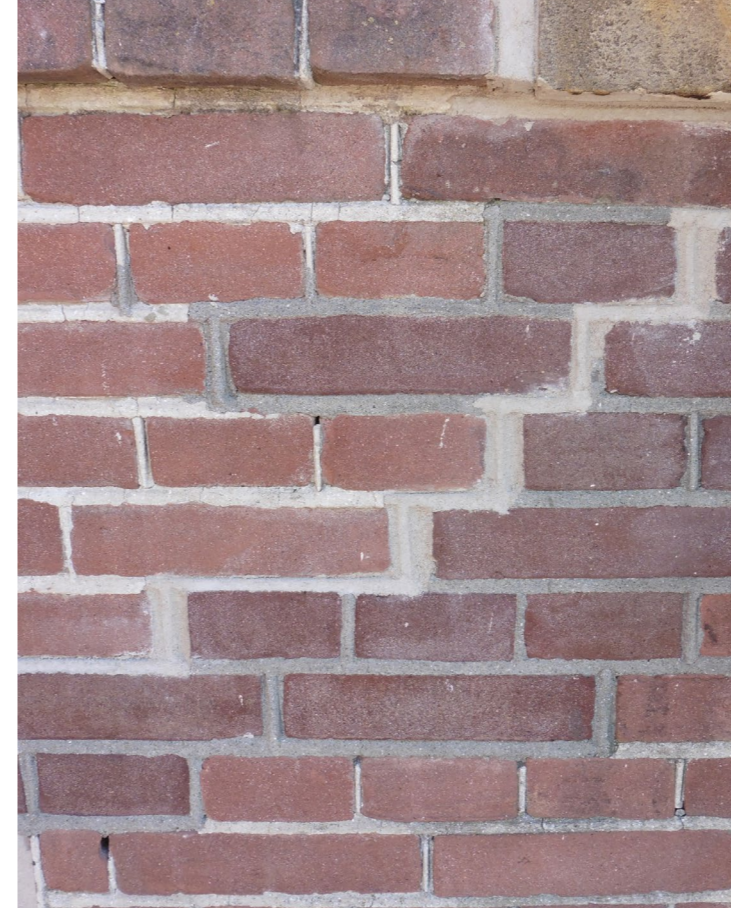
Afbeelding 3: Voorbeeld van diverse soorten voegwerkherstel, waarbij duidelijk het verschil zichtbaar is tussen de wat lichtere kalkhoudende voeg en de donkere cementhoudende voeg. In het midden een opnieuw gevoegde trapscheur.
