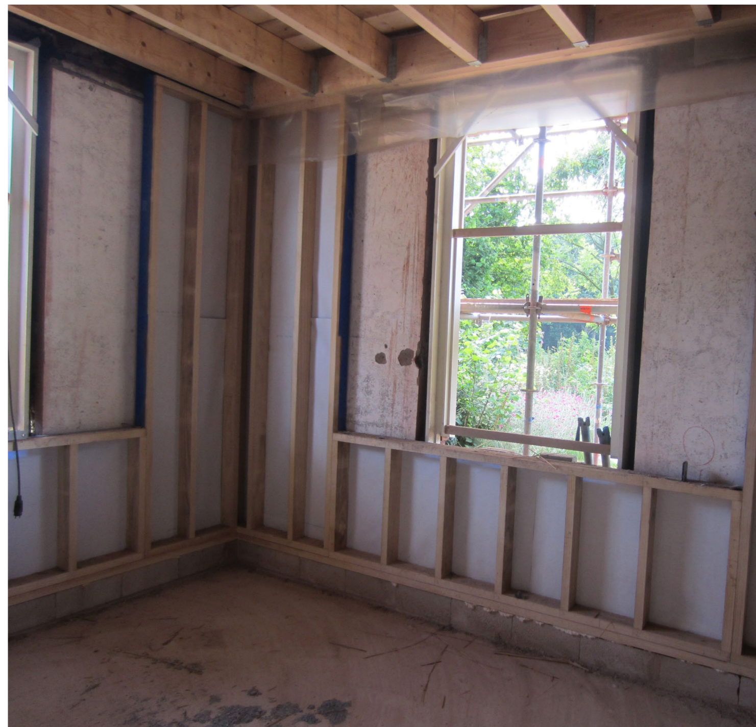
Afbeelding 2: Tweede voorbeeld van een houten stijl- en regelwerk wat achter de bestaande gevels is geplaatst, de isolatie moet nog worden aangebracht.
