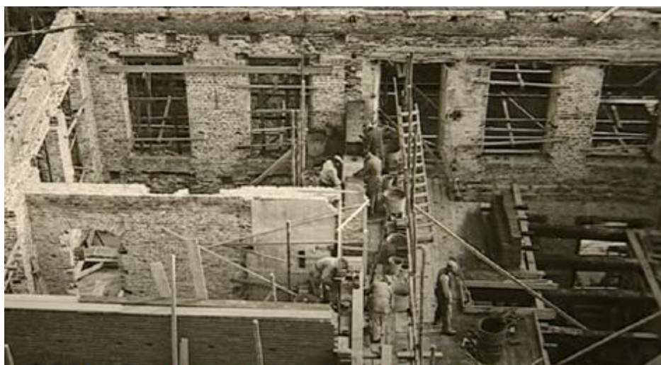
Metselwerk in uitvoering op de verdieping van het kasteel in 1939. (Kasteel Huis Bergh)
