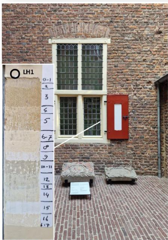
Figuur 16. Kleurtrap op het raamhout in het binnenplaats en locatie van dwarsdoorsnede LH1.
